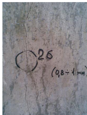
Рисунок 6 – Вертикальная трещина вблизи четвертой оси на внешней стороне оболочки [Vertical crack near the fourth axis on the outside of the shell]
