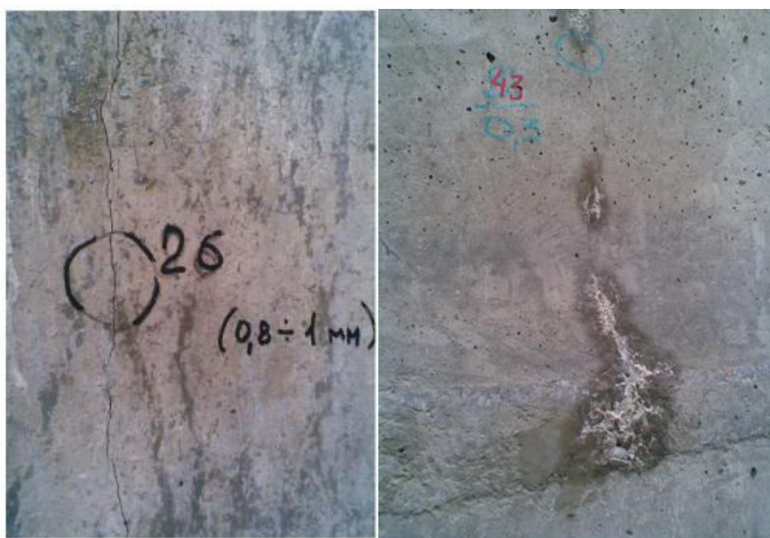
Рис. 10. – Трещины стены защитной оболочки
